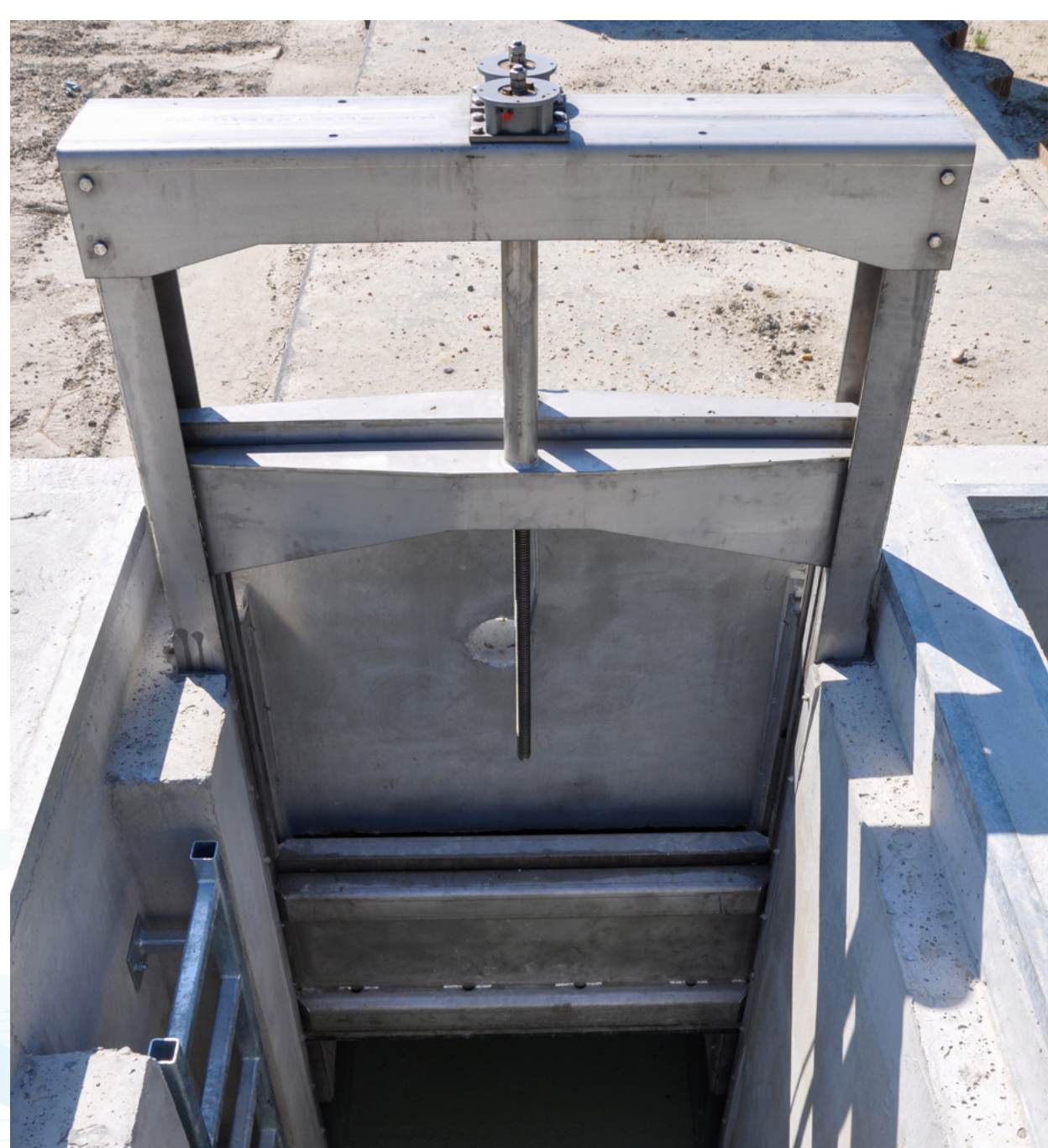
A vasbeton szerkezetben elhelyezett főelzárás
